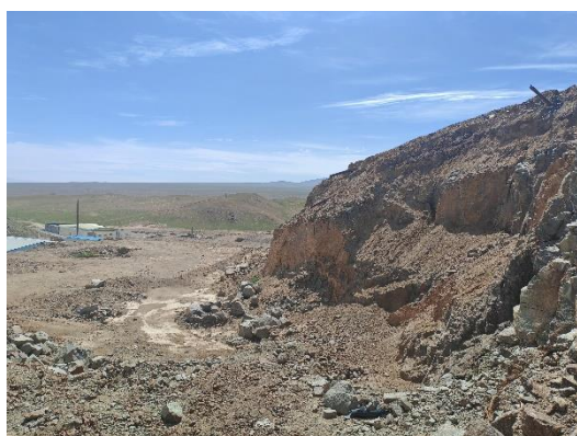
图 3-7 Q_5 不稳定斜坡
