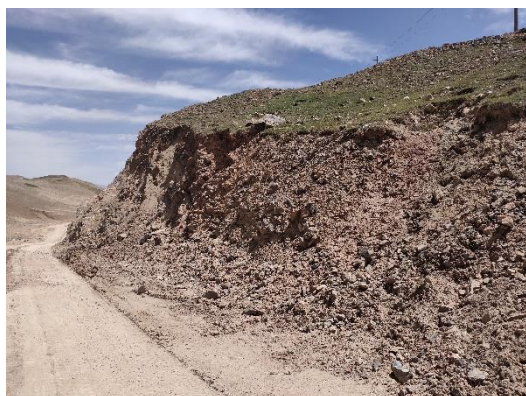
图 3-9 Q_7 不稳定斜坡
