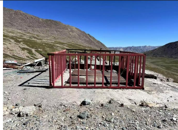
照片2.7.4 SJ1防护栏建设及回填后为防止雨水破坏地质用钢板进行遮盖
