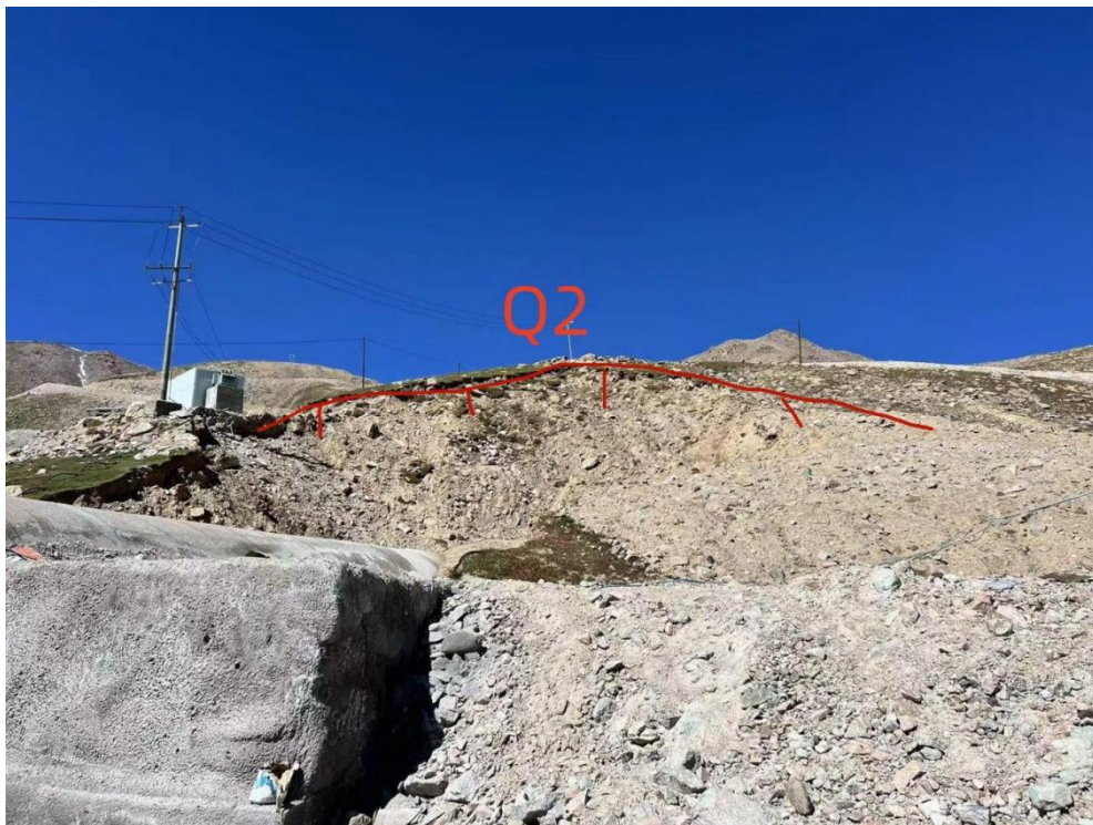
图3.2.2 不稳定边坡 Q_2 照片
