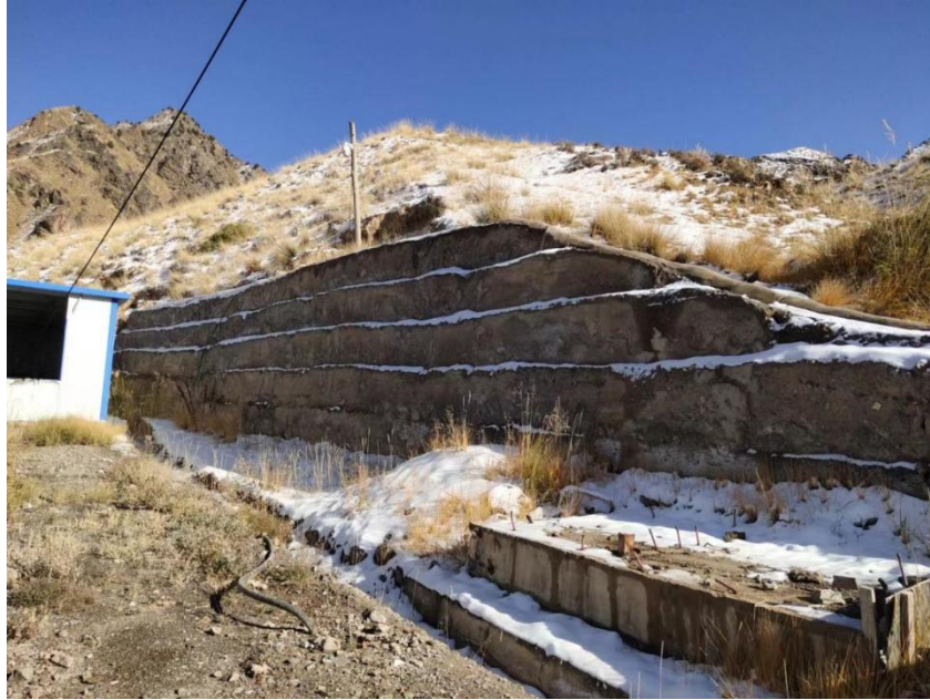
照片 3-1 Q 1 不稳定斜坡拦挡墙
