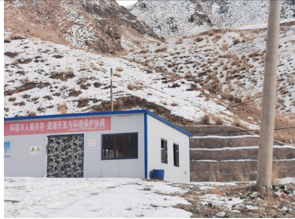
照片17 变配电室
