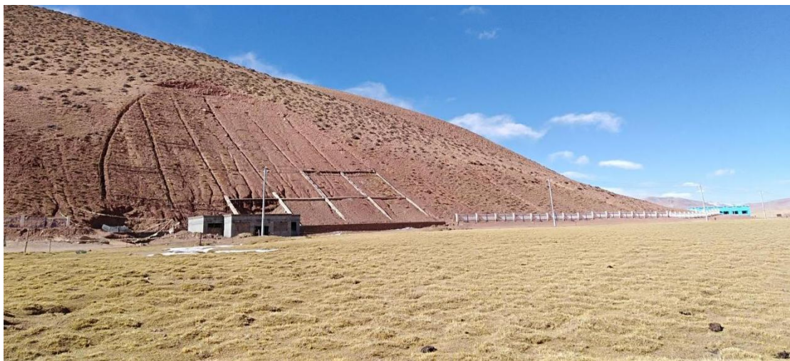
图3-1 水源井房后侧不稳定斜坡
