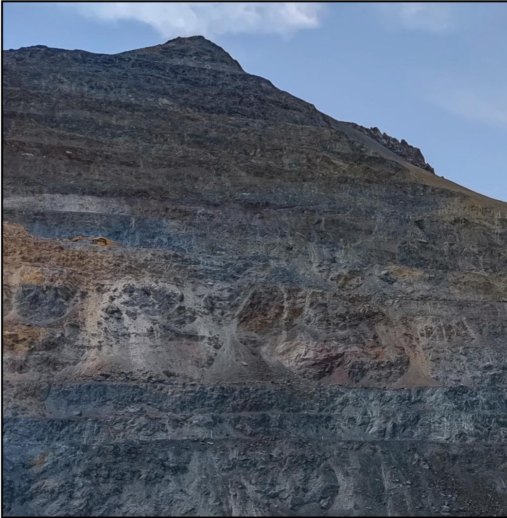
图 3-7 Q 5 边坡崩塌体
