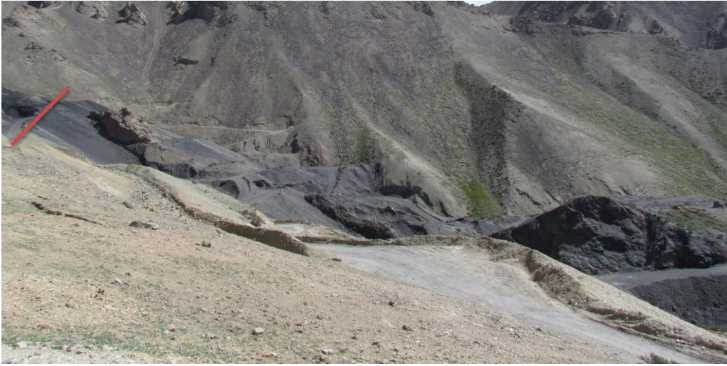
照片 3.2-1 不稳定斜坡 Q 4 m1
