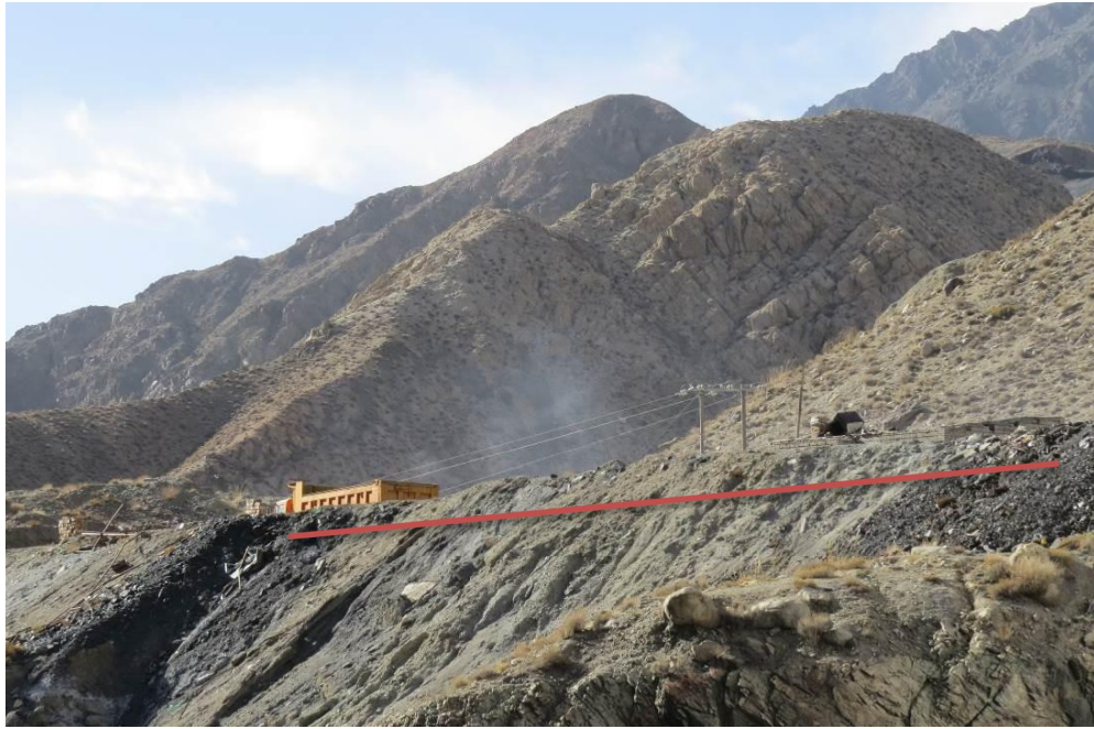
照片 3.2-1 不稳定斜坡 Q 1
