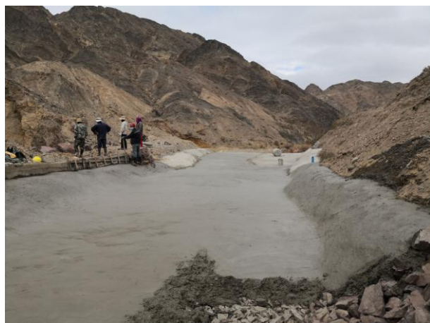
照片 2.6-8 地面塌陷治理 镜像 E
