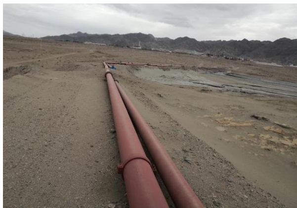
照片 1.3-18 尾矿输送管线 镜向 W (6) 选矿厂
