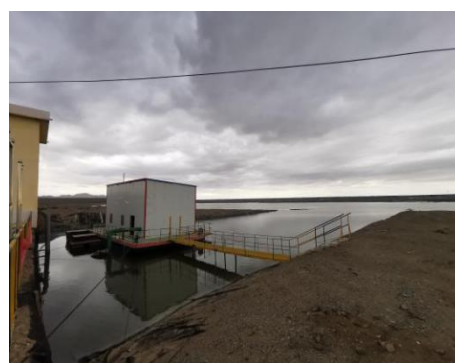
照片 2.6-2 尾矿库回水一级泵站
