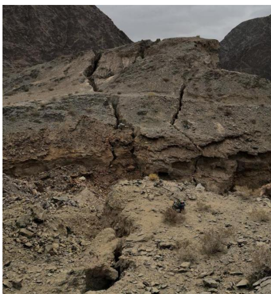
照片 3.2-10 TX1 塌陷区照片（镜向 ES）
