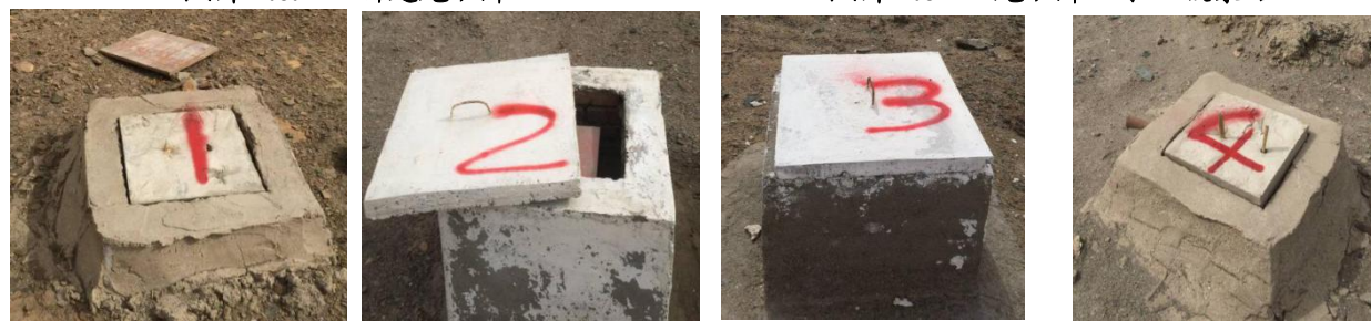
照片 2.6-3 防渗监控井
