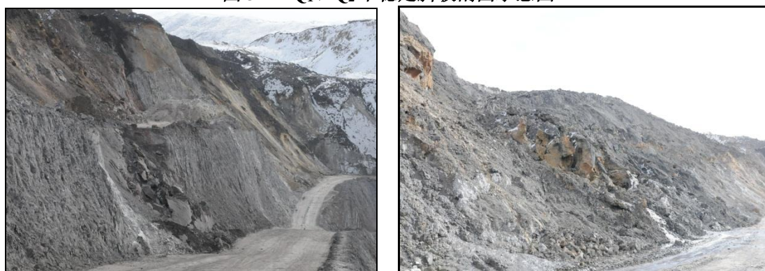
照片 3-1 Q 1 不稳定斜坡照片
