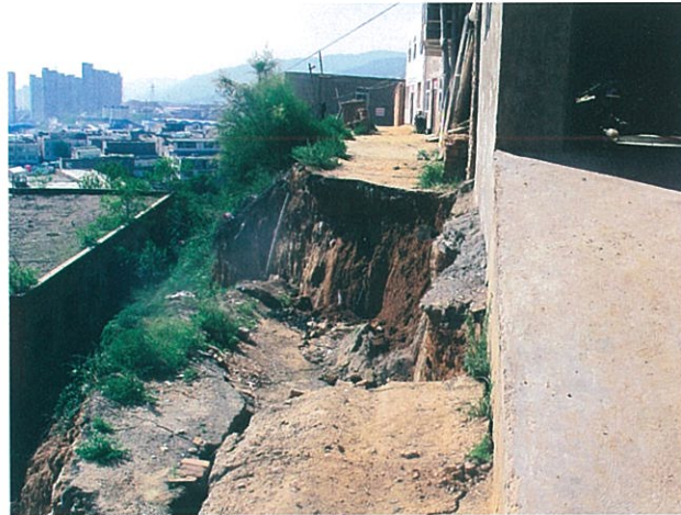
西宁市城中区苦水沟滑坡体威胁房屋
