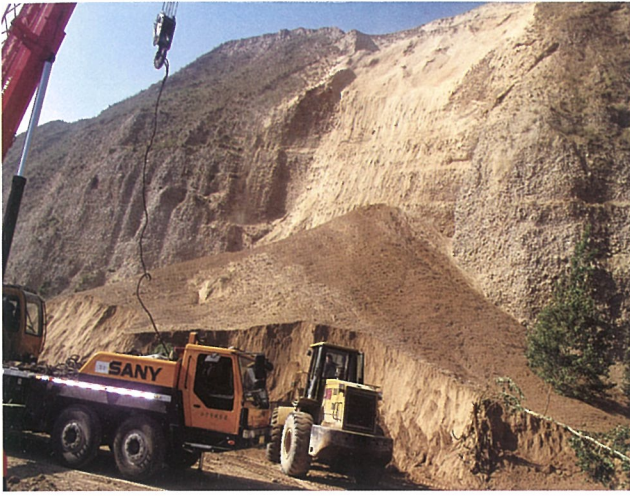
乐都区洪水镇青崖根国道 109 线 K1875+800m 处 人工弃土滑坡
